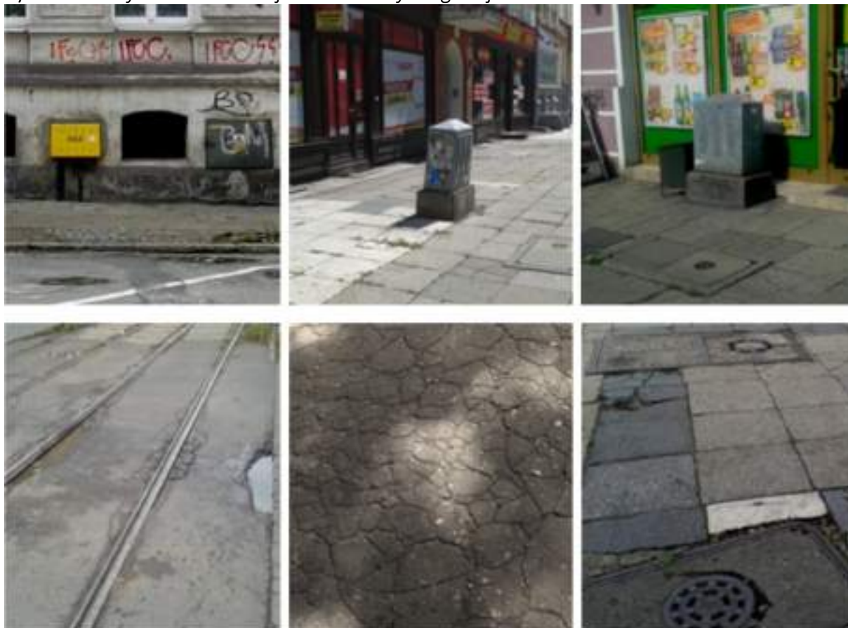
Rysunek 20. Zły stan technicznej infrastruktury drogowej
