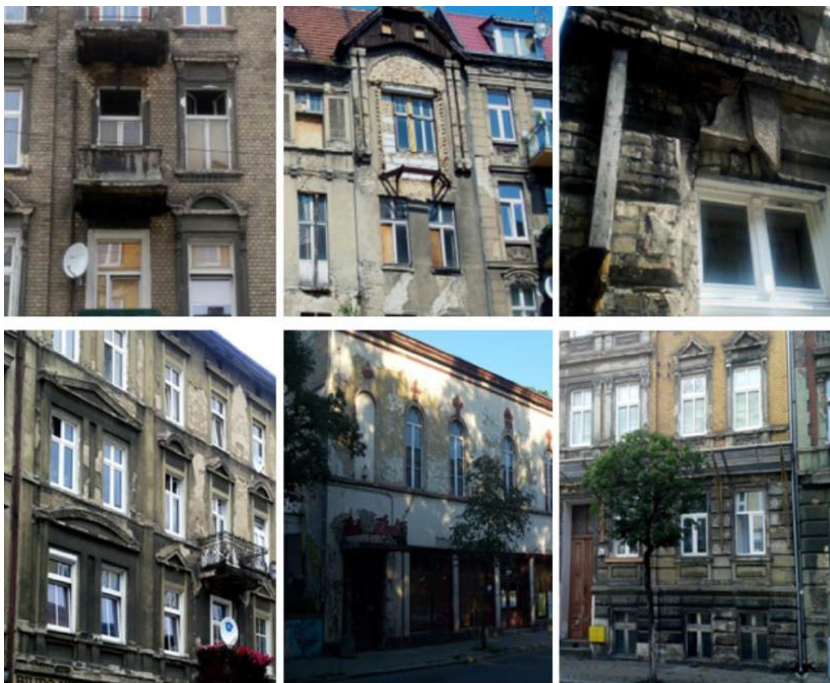
Rysunek 23 Stan techniczny przykładowych budynków w obszarze rewitalizacji.
