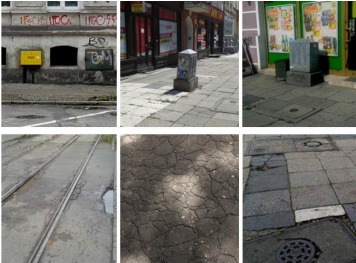
Rysunek 16 Zły stan technicznej infrastruktury drogowej
